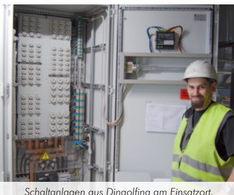
Schaltanlagen aus Dingolfing am Einsatzort.
