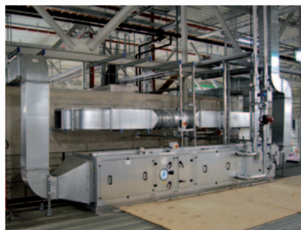
Eine Nebenstelle der Lüftungsanlage.
